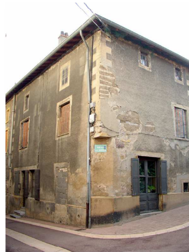
L'enduit, qui commence à fuser, met en évidence la maçonnerie de pisé. Savigny.
