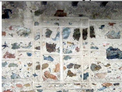
Joints à pierre vue : un décor de fausse fenêtre (boudins de mortier) est posé en surépaisseur. Taylan
